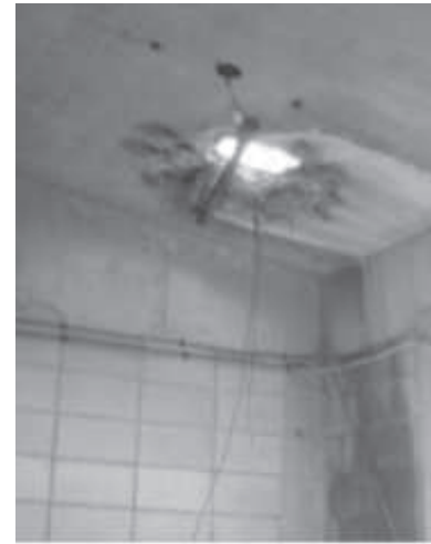
写真3 2000年三宅島噴火時の大きな噴石で穴の開いたコンクリート建築
